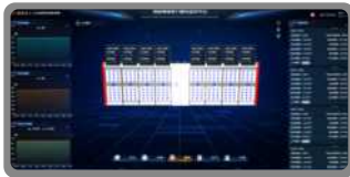
制冷监控面板
